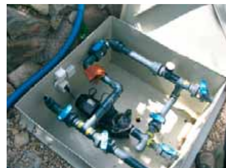
Šachta s ventilovými rozvody
